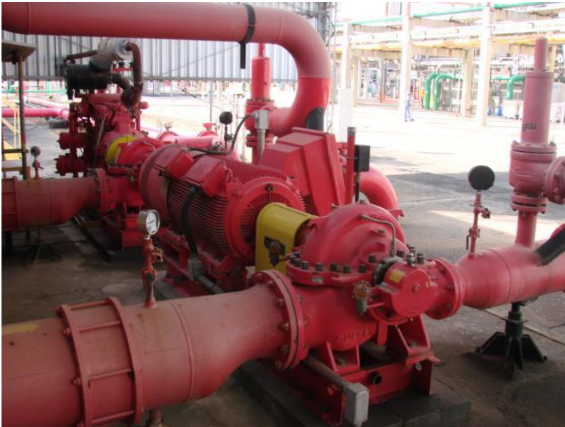
Figura 2: Bomba de combate a incêndio instalada no ambiente de trabalho. Registro antes da retirada para manutenção.
