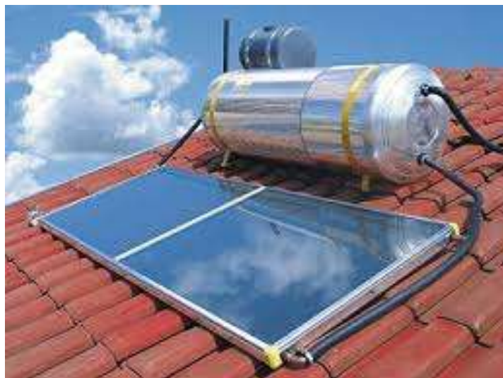
Figura 13 – Sistema de Aquecimento Solar
